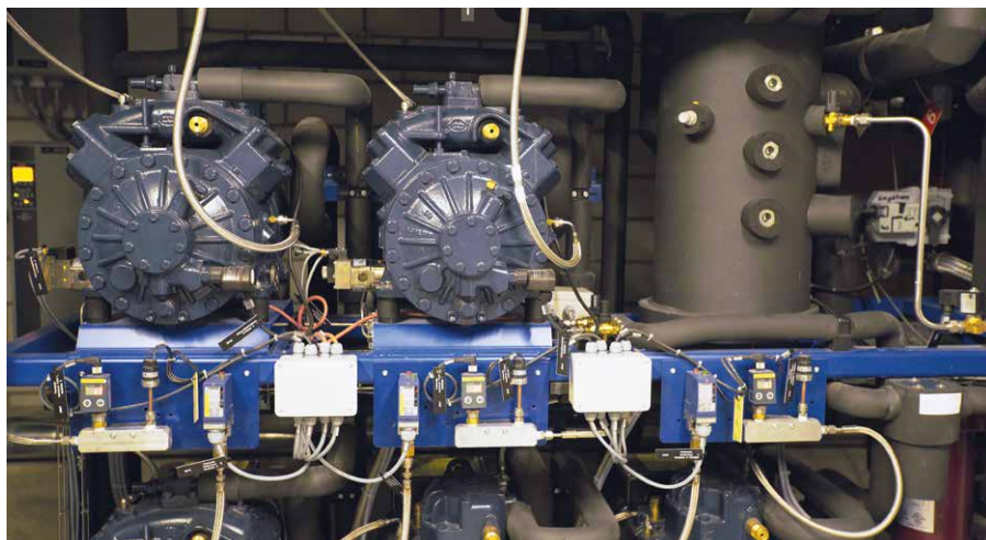
Kälteanlagen mit klimafreundlichen Kältemitteln leisten einen wichtigen Beitrag zum Klimaschutz. (Bild: Stiftung KliK)
